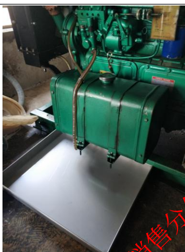
发电机房防渗托盘
