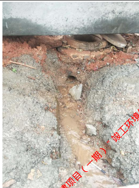
沉淀池导流沟
